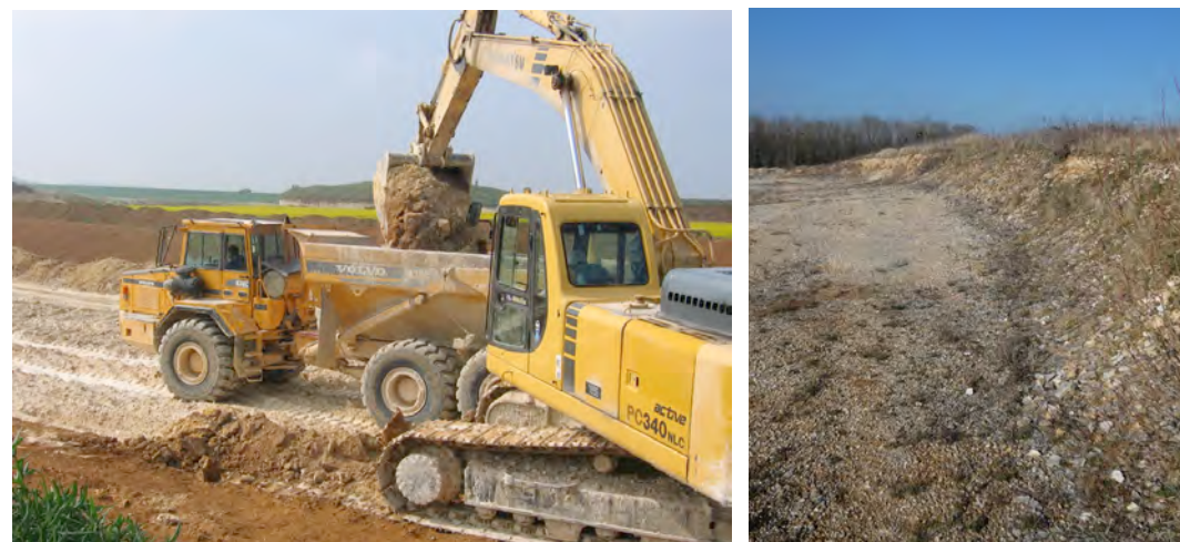
Exemple de décapage à la pelle (carrière du Groupe) Le front de découverte sur la zone d'exploitation ▲
