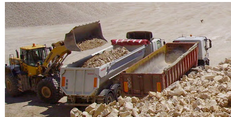
Chargement d'un camion ▲
